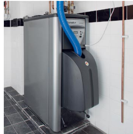
1. Stäng alltid av strömmen till pannan ett par timmar innan rengöring.
